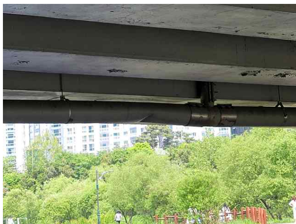
배수시설 S1 배수관 변형
