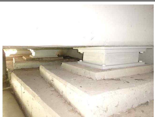
교량받침 부식 - 보수
