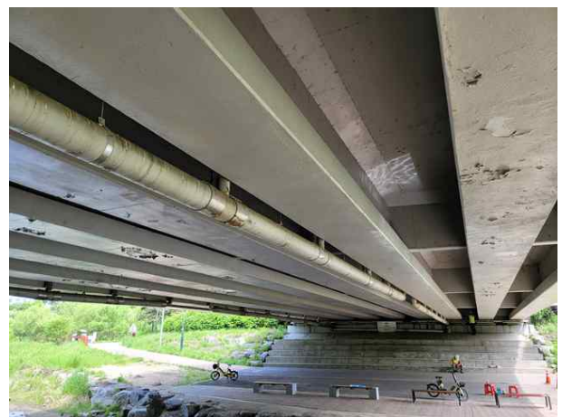
배수시설 S1 배수관 부식
